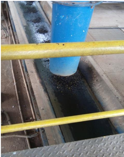
(g) Aspecto visual da areia retirada do desarenador.
